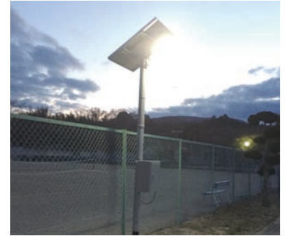
学校に設置された自立式の太陽光パネル&LED電気・蓄電池
